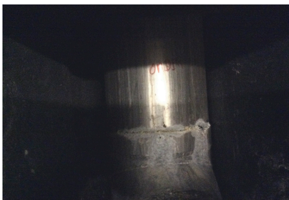
Lekkage door corrosie
