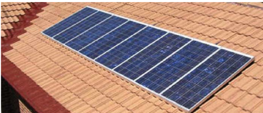
Afb. 15 PV-panelen met afmeting van ongeveer 1,55 x 0,80 meter (4,5 pan hoog, 4 pannen breed)
